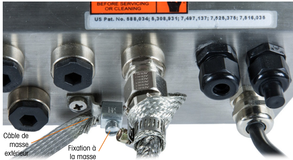
Figure 2-65 : Câble et tresse installés dans une enceinte pour environnement difficile
