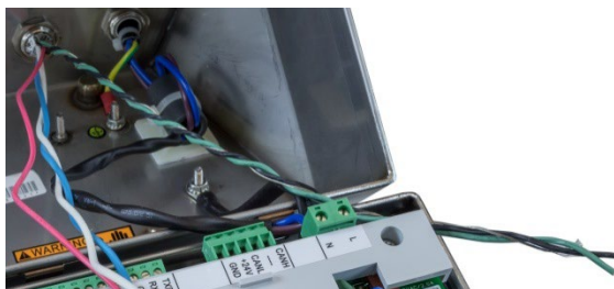
Figura A-52: Cables de conexión a tierra y alambre de fuga interno torcidos juntos
